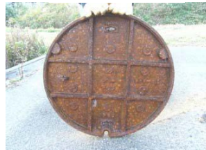
マンホール蓋の腐食
