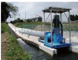
水路の落差を利用した小水力発電施設
