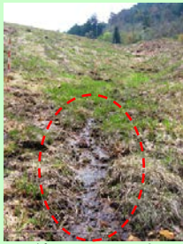
堤体からの漏水
