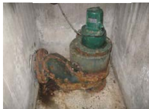
機械設備の発錆・腐食
