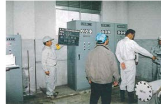
揚水機の診断
