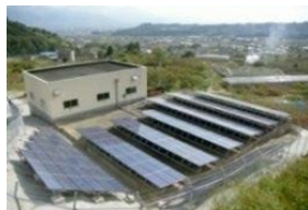
農業水利施設を利用した太陽光発電施設
