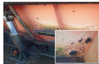
【可動堰 堰体塗装劣化】
