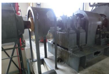
【排水機場 グリス漏れ】
