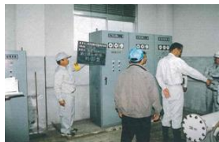
揚水機の診断
