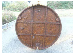
マンホール蓋の腐食
