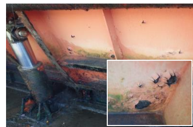
【可動堰 堰体塗装劣化】
