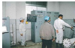
揚水機の診断
