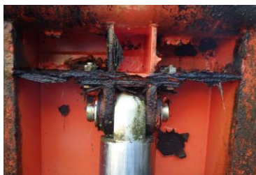
【可動堰 堰体部材腐食】
