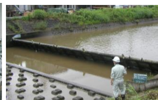
頭首工の診断
