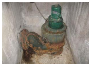
機械設備の発錆・腐食
