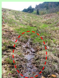
堤体からの漏水
