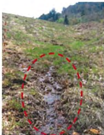
堤体からの漏水
