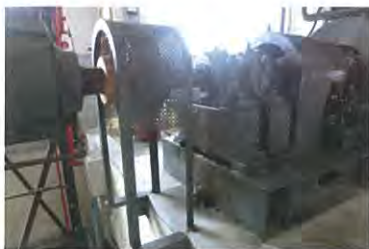
【排水機場 グリス漏れ】
