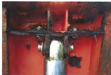
【可動堰 堰体部材腐食】
