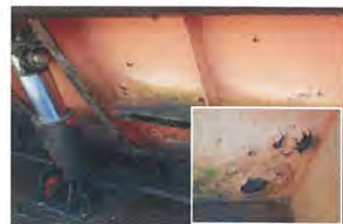
【可動堰 堰体塗装劣化】
