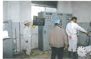
揚水機の診断
