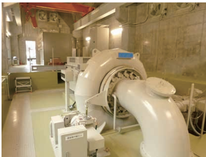
発電施設内（中央が水力タービン）
