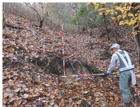
堤体の漏水・崩壊
